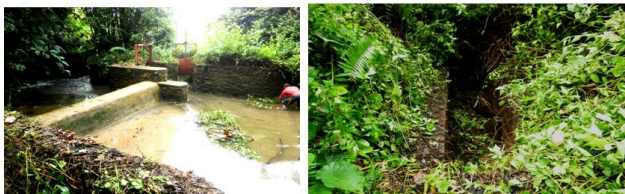
Mubazir, bendungan Mata Air Tingkea o yang sempat dikunjungi wartawan KOPI (kiri). Drainase saluran irigasi yang tidak berfungsi baru nampak setelah disiangi dari tumbuhan rerumputan hutan (kanan).
